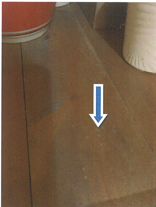
zdj. 20 Podłoga w zakrystii ze śladami grzybni.
